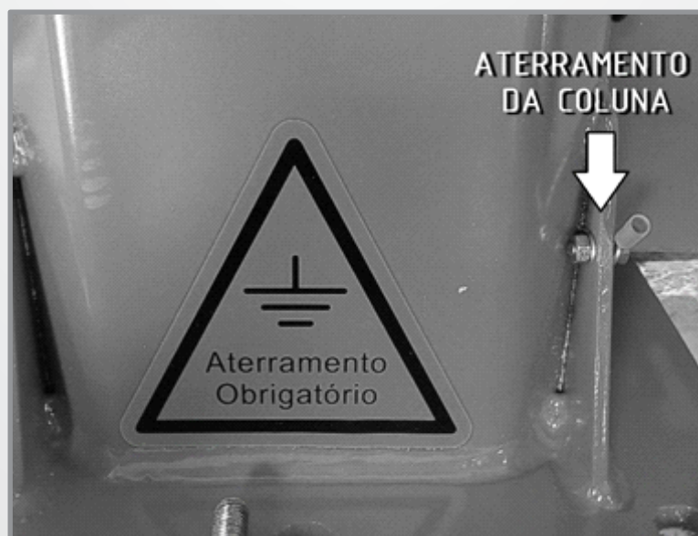
Ponto de aterramento da coluna
