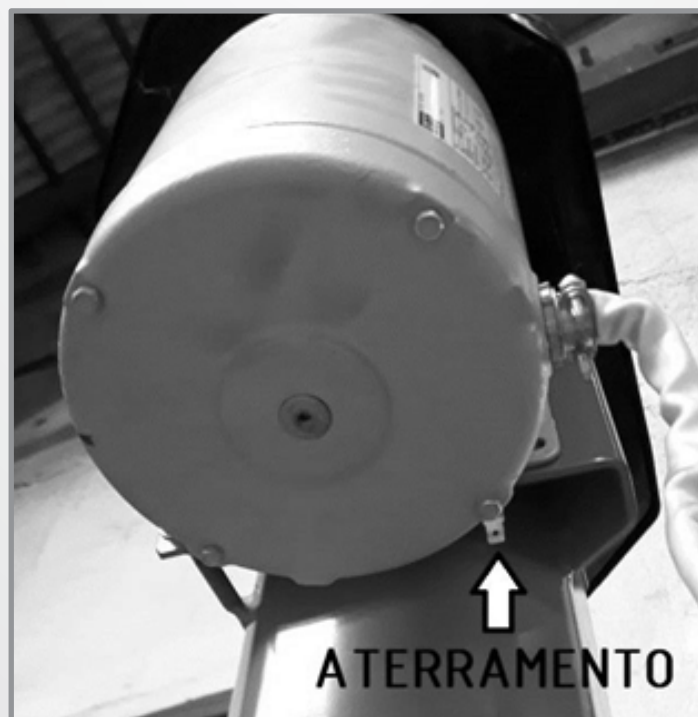
Ponto de aterramento do motor
